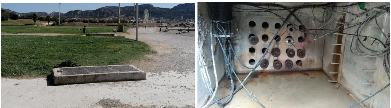
Figure 19 : Photos extérieures et intérieures de la chambre plage existante (source : Orange)
