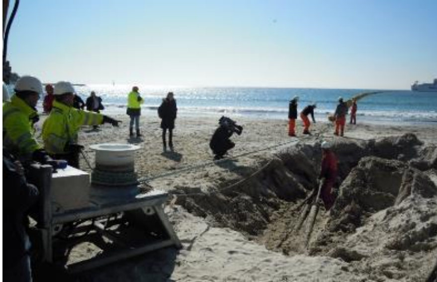
Figure 25: Opération de tirage du câble à terre avec un cabestan hydraulique (source : Orange marine)
